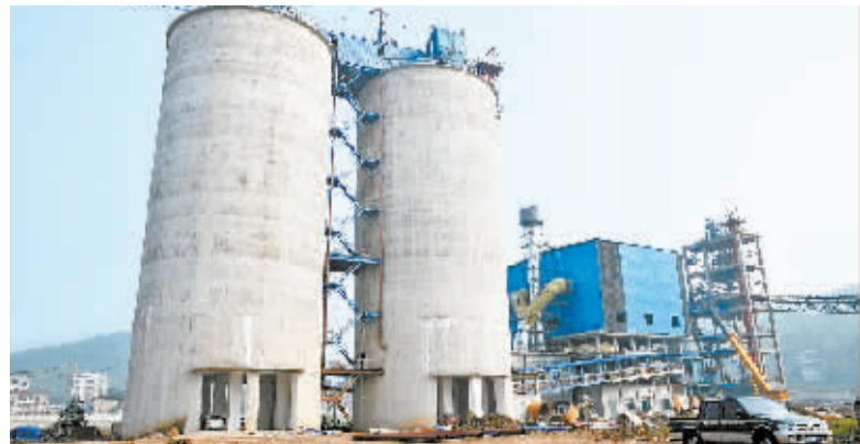
7月28日,冷水江钢铁厂120万吨超细粉生产线一期工程进入最后的设备安装调试阶段。该工程总投资1.6亿元,是我省“沪洽周”重点招商引资建设项目。 熊又华 摄
