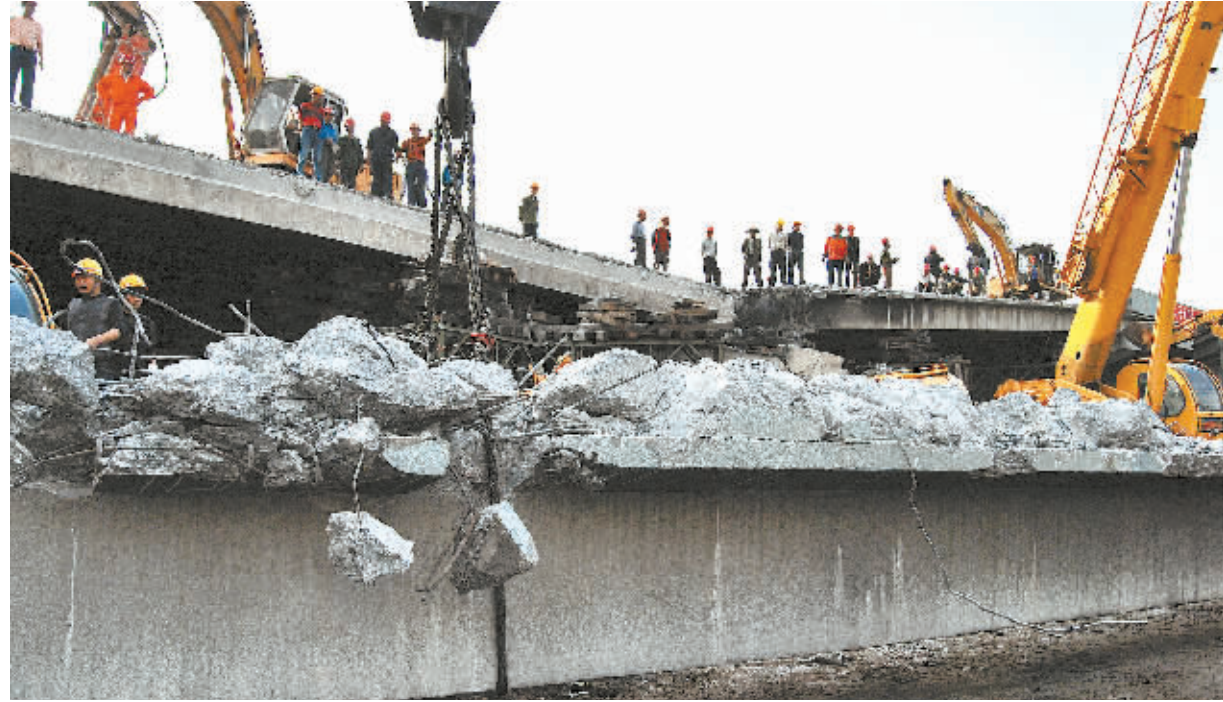
4月20日,京珠高速公路郴州段“4·17”重大交通事故中被撞垮的桥梁开始拆除,预计拆除工作在一周内完成,然后进行重建。施工期间,仍实行单幅双向通行。 贺茂峰 陈小平 摄
