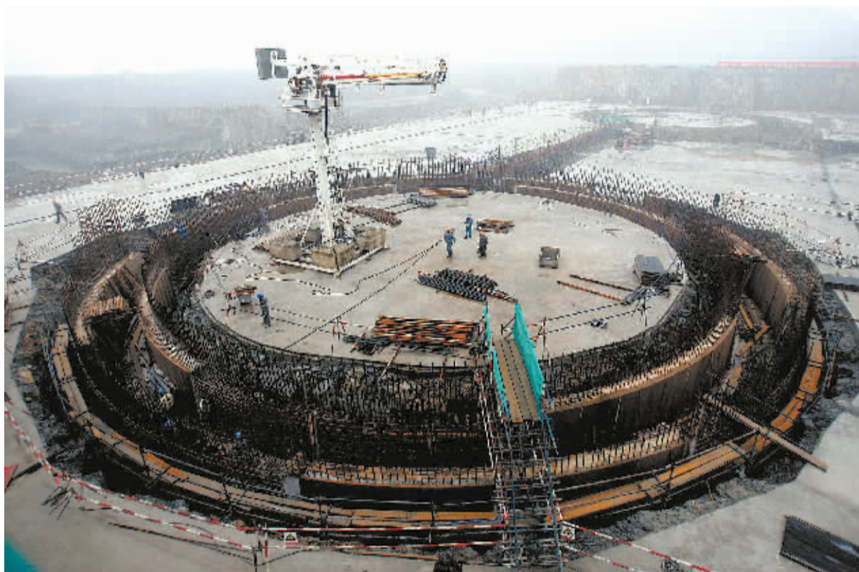
位于浙江海盐的方家山核电工程是中国首座核电站——秦山核电站的扩建工程,规划建设两台百万千瓦级压水堆核电机组。图为在建的方家山核电工程核岛区。
