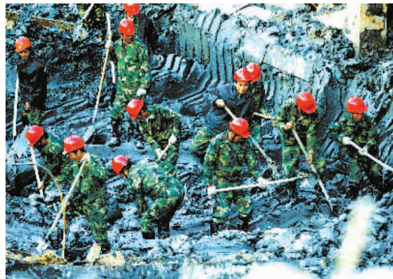
图为11月18日,工程人员在杭州地铁工地塌陷事故现场继续清理废墟、寻找仍然失踪的13名工人。新华社发
