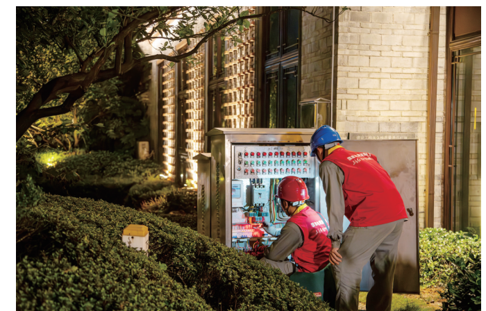
国网郴州供电公司保电工作人员在郴州长卷文化旅游度假区检查配电设备。(国网郴州供电公司供图)
