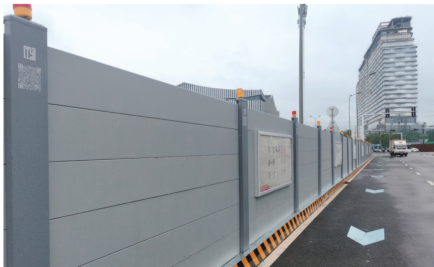
长沙国际会议中心核心区光达停车场及公共绿地建设工程项目安装的新型装配式围挡(B类)。
