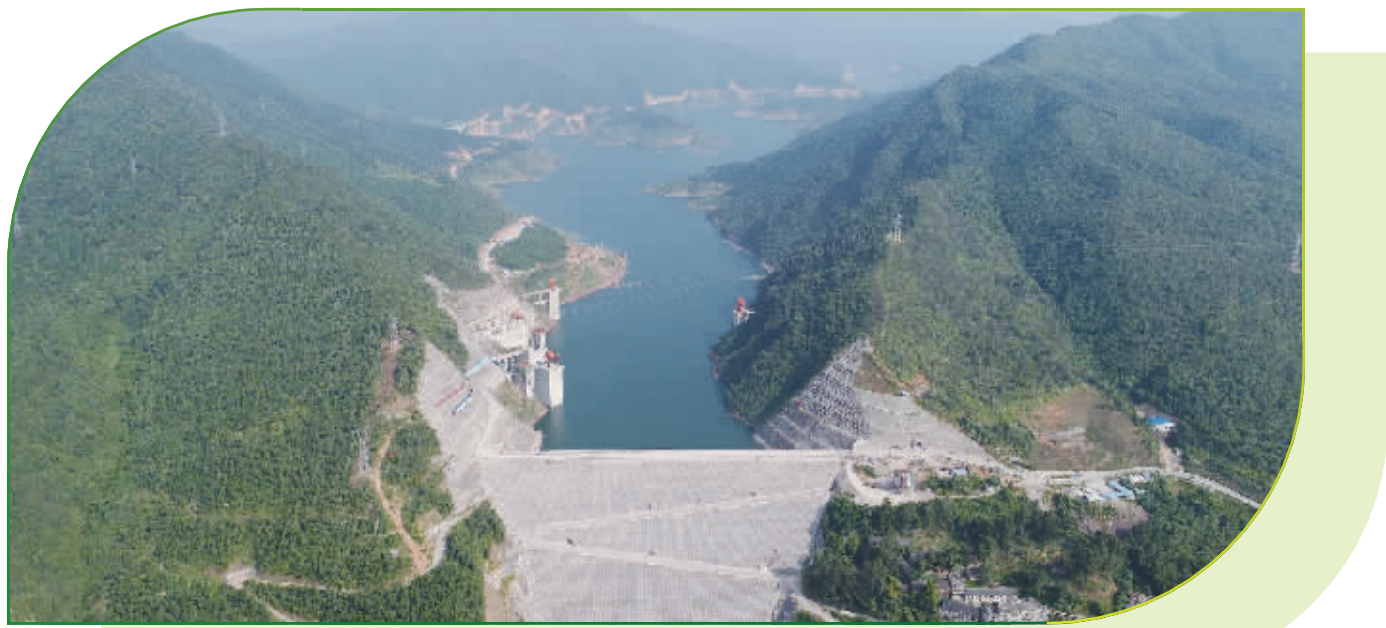
2018年,正在实施的国家172项重点水利工程之一,溇天河水库扩建工程。 童迪 摄
