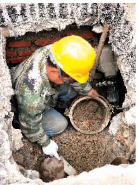
城网改造:为提高通惠社区的供电可靠性和供电能力,宁乡市供电公司对该片区进行新增布点工作。图为该公司正在进行新增变压器的相关工作。 王奥 摄
