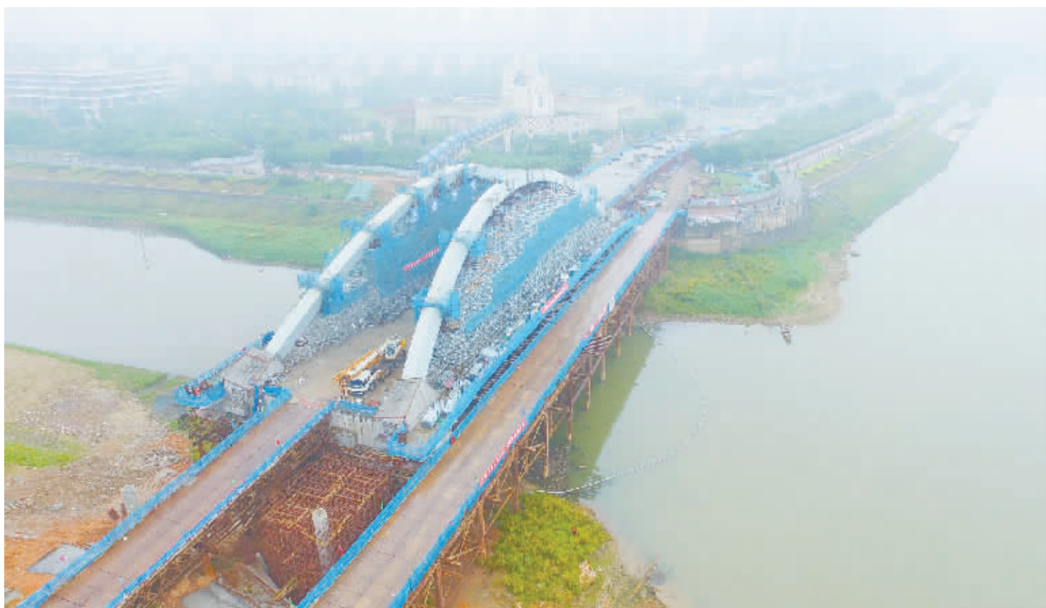
大桥合龙 5月22日,对接长沙浏阳河大道与川河路的圭塘河大桥东西双向主拱合龙。新建的长沙圭塘河大桥是一座提篮式拱桥,全长351米,双向四车道通行。湖南日报记者 徐行 通讯员 范梅开 摄影报道
