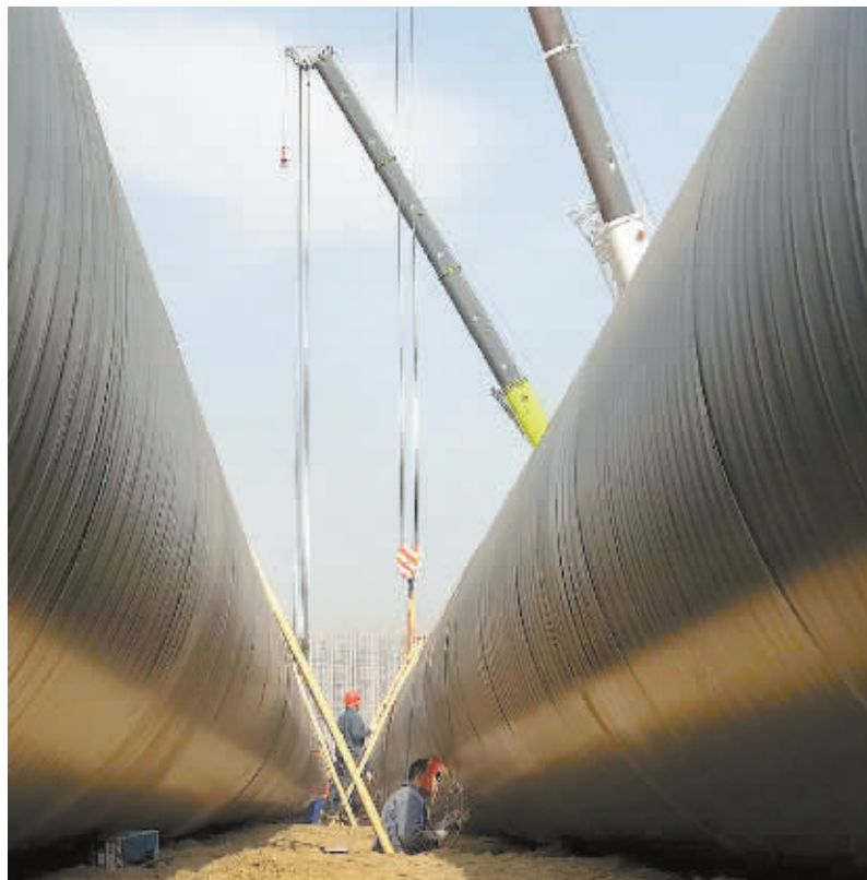
3月27日,岳麓污水处理厂尾水排放工程现场,技术人员在焊接管道。该管道直径2.2米,每根管道长12米,整个排放工程管道长达20000多米。
