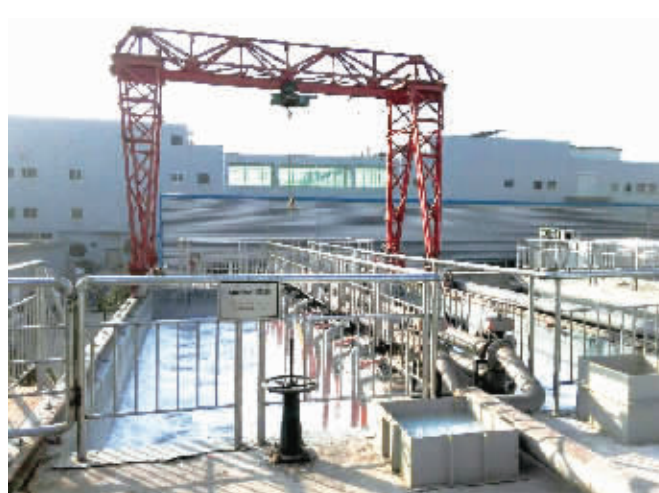
湖南景型环保公司是专业从事综合环境治理服务的高新环保企业。图为该公司建设和运营的蓝思科技电子屏玻璃研磨废水处理及综合利用工程。(本版图片除署名外由省环保厅提供)
