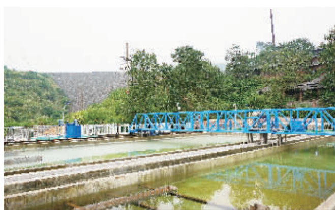
长沙赛恩斯环保科技有限公司是中南大学产学研合作企业,是一家能够提供全方位环境治理服务且拥有完整产业链的环保公司。图为该公司在闪星铝业公司承担建设与运营的一家重金属污染处理厂。黄亮斌 摄
