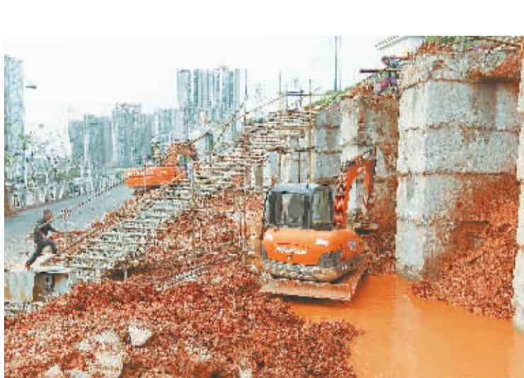
4月13日，施工人员在长沙世界之窗东侧抢修护坡。因连续下雨，世界之窗东侧靠路边的护坡多次出现垮塌，长沙县相关部门迅速行动，组织抢修。 本报记者 刘尚文 摄
