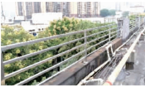
由于建造年限长达14年之久，长沙县创业乐园小区顶楼护栏风吹日晒已锈蚀严重，存在一定的安全隐患，居民迫切希望改善居住环境。目前，楼顶护栏已进行了集中更换和维护。 熊冰倩 摄
