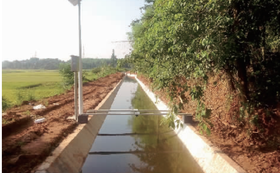
攸县农业水价综合改革项目区流量监测站。
