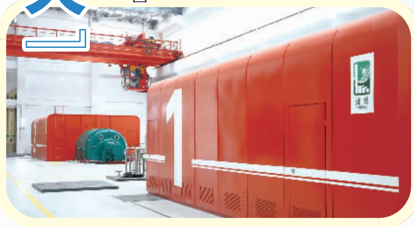
▲ 长沙市生活垃圾深度综合处理(清洁焚烧)项目。 ▼ 汽轮发电机组。
