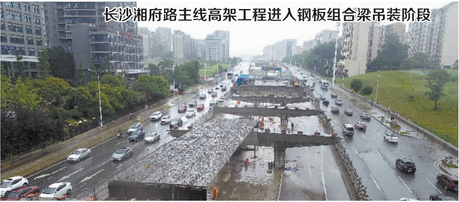
6月1日,长沙市湘府路快速化改造项目(Ⅱ标段)工程主线高架首联预制钢板组合梁吊装成功,标志着湘府路快速化改造项目Ⅱ标段主线高架工程进入桥梁上部结构建设阶段。该快速化改造项目Ⅱ标段全长3.678km,其中桥梁工程全长3.351km。湖南日报记者 李健 通讯员 李龙 摄影报道
