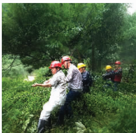
平江县供电公司火速开展抢修,将浸泡在溪流中电线拉上岸。
