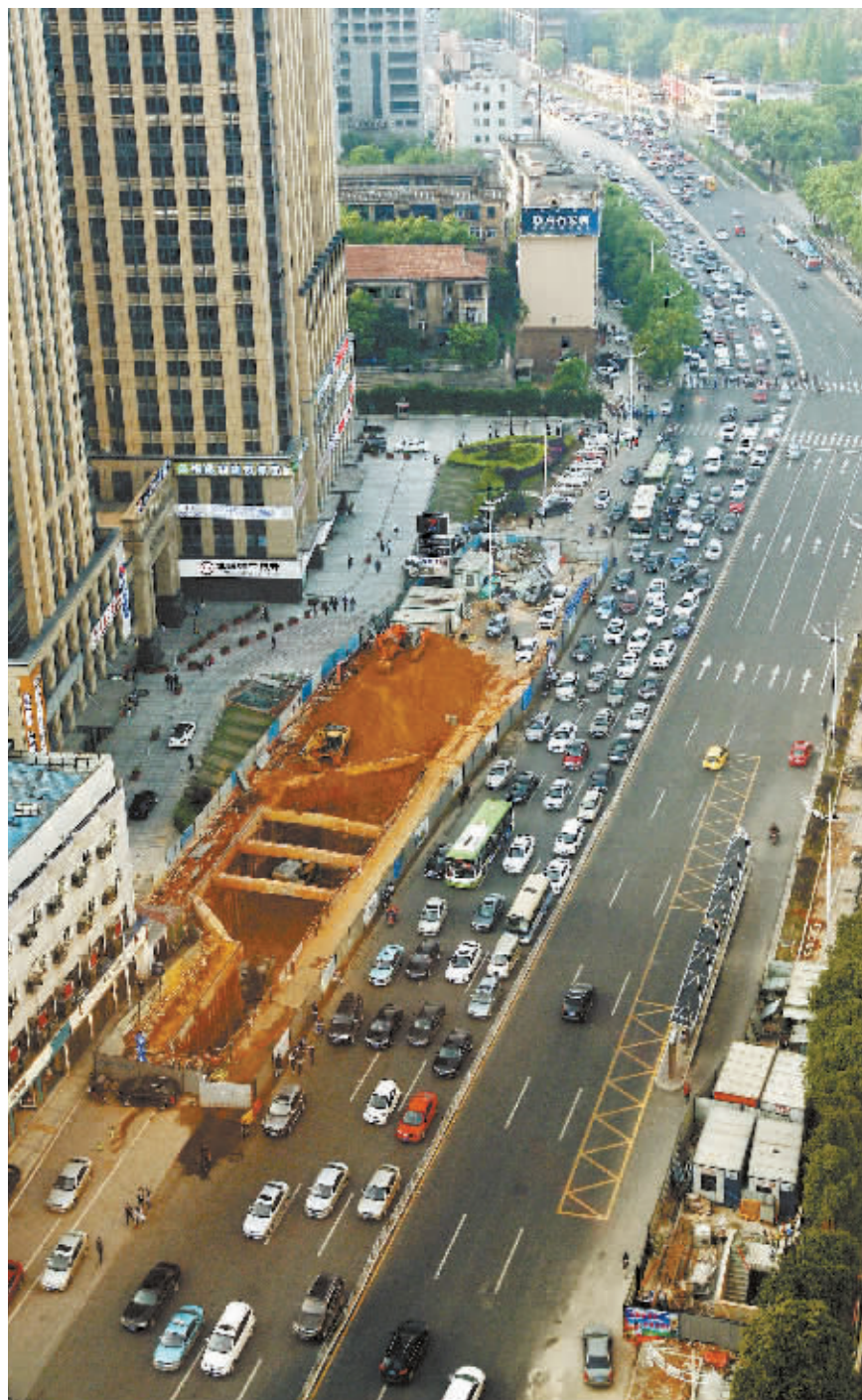
4月18日,正在建设中的长沙地铁4号线黄土岭站。该站位于芙蓉中路与黄土岭路交叉路口处,沿黄土岭路呈东西向布置,是最难施工的站点之一。
