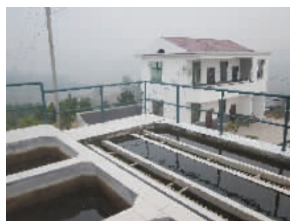
桂阳浩塘水厂管网延伸工程让周边6000多人喝上干净水。图为浩塘水厂反应沉淀池。
